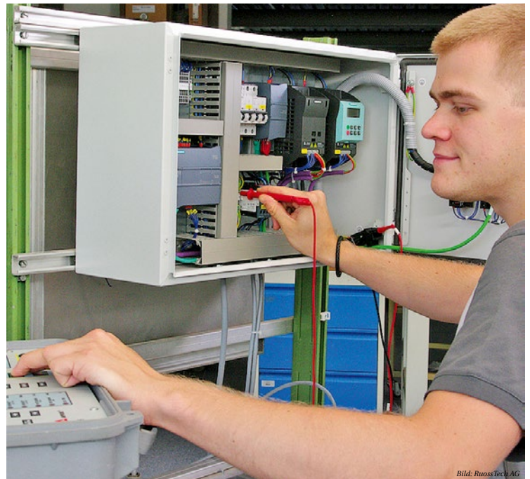
Prüfen einer Anlagensteuerung.
